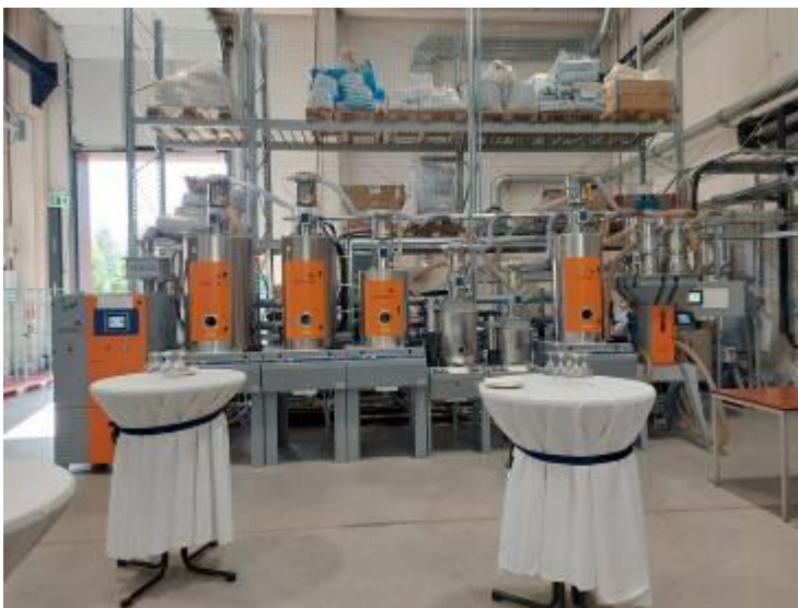
Photo 2: motan Trocknungs- und Förderanlage in der LIT Factory (motan group)
