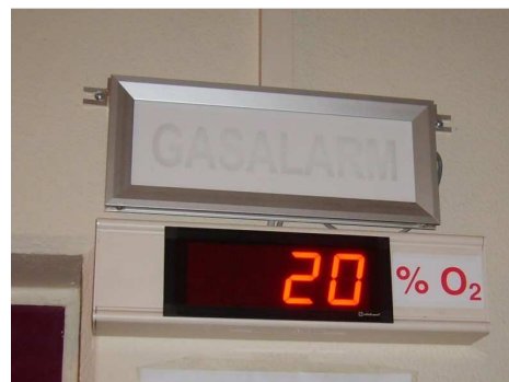
Anzeige vor dem Stiegenabgang im Erdgeschoss für Sauerstoffgehalt vor dem Abfüllraum im Kellergeschoss.
