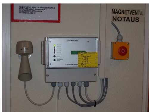
O 2 -Überwachungsgerät im Kellergeschoss mit Hupe (links) und Notaus-Taster (rechts) für flüssig-Stickstoffleitung.
